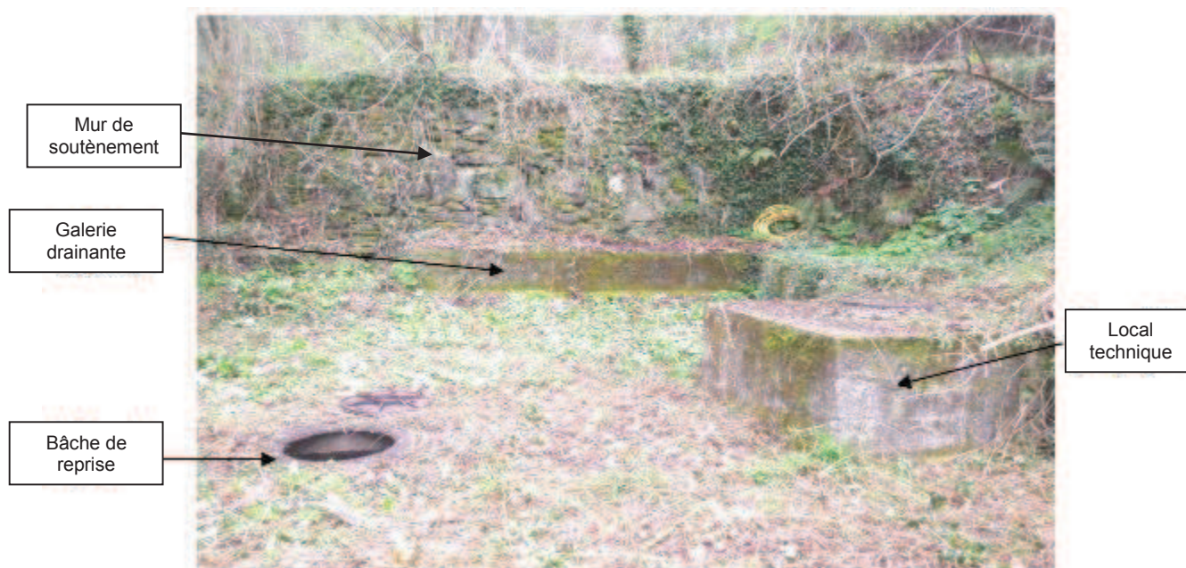
Figure 4 : Vue d'ensemble du captage des PONCHETS
