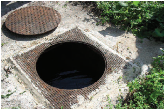
Planche photographique n°5 : vue du tampon d'accès à la bâche de reprise
